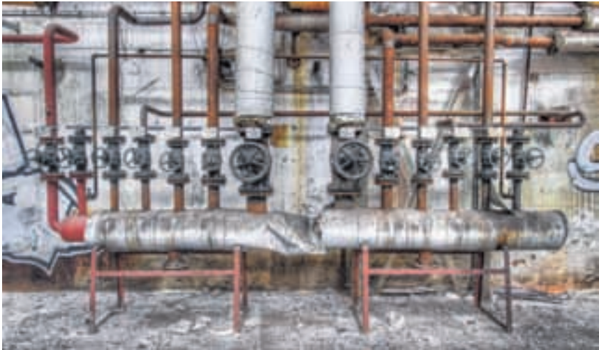
Typisches Bild einer Energieschleuder.
