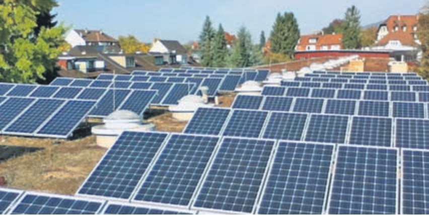
Die Photovoltaikanlage auf den Mehrfamilienhäusern an der Arnikastrasse 24 und 26.
