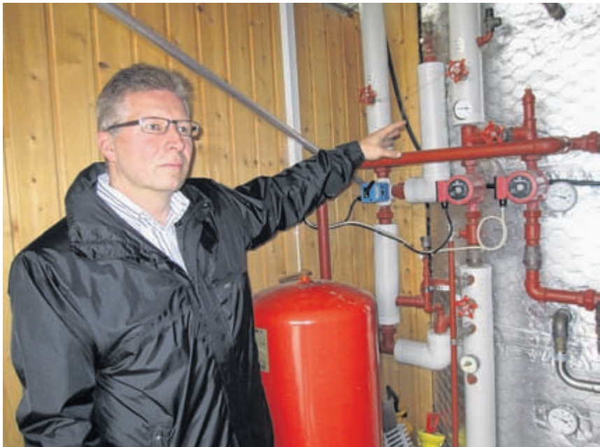
Der Bettinger Gemeindepräsident Patrick Götsch erläutert vor dem Boiler im Gartenrobengebäude, wie die mit Sonnenenergie gespiesene Warmwasseranlage des Gartenbads Bettingen funktioniert.
