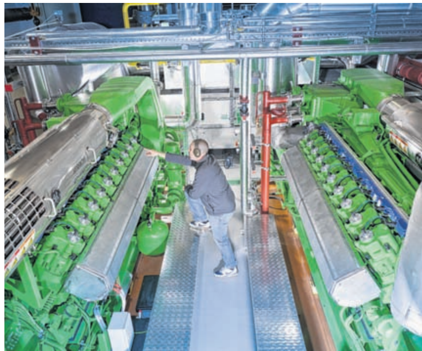
Die grossen Gasmotoren des Blockheizkraftwerks im Untergeschoss des Werkhofs der Gemeinde Riehen am Haselrain, die der Geothermianlage dienen.
