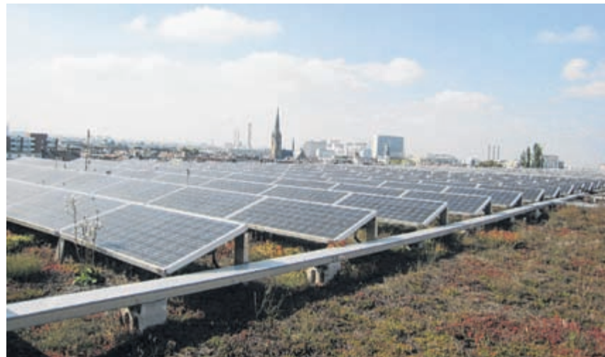
Umweltfreundliche Energieproduktion: die Fotovoltaik-Anlage auf dem Messdach in Basel.
