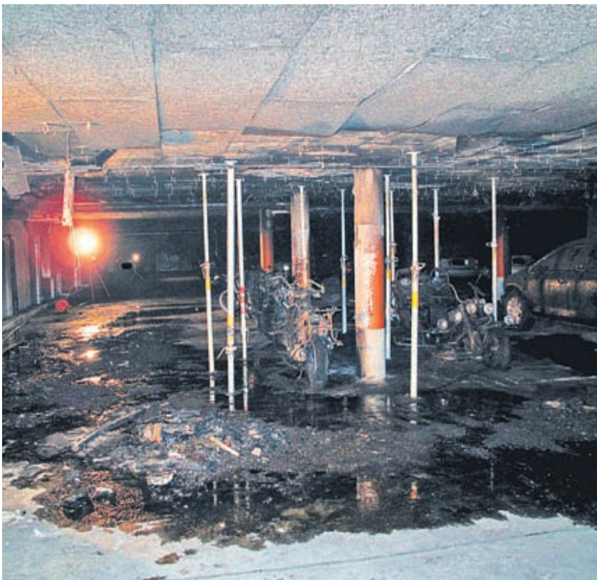
Die verwüstete Garage am Rüchligweg.
