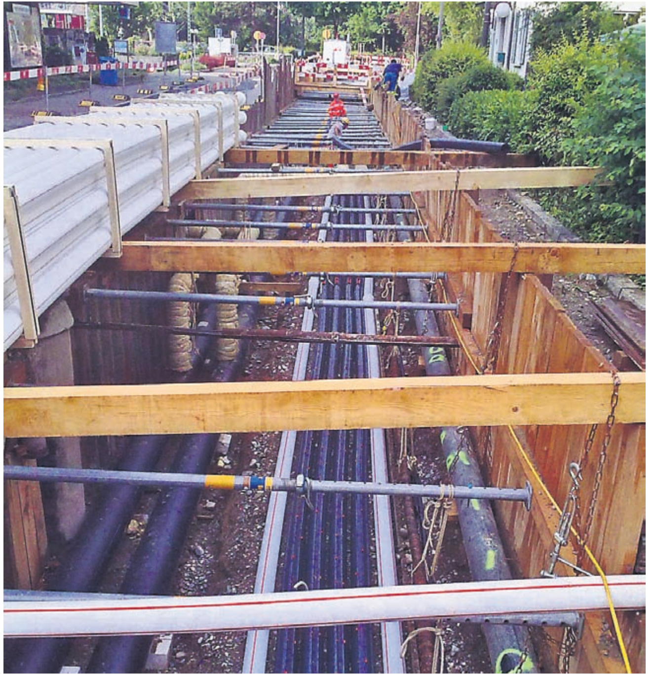
Mehr als nur ein Verkehrsweg: Unter den Riehener Strassen laufen diverse Versorgungsleitungen für Gas, Wasser, Strom, Fernwärme und Telekommunikation. Im Bild ist die Bahnhofstrasse zu sehen. Foto: zVg
