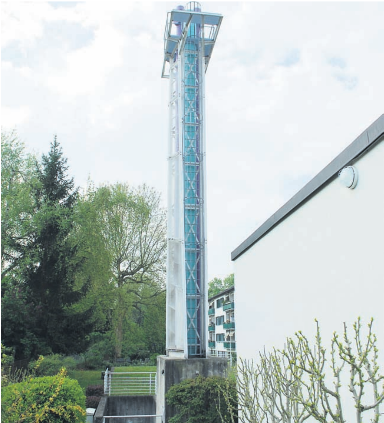
Der kleinste der drei Partner: die Heizzentrale der Niederholz AG am Keltenweg.
