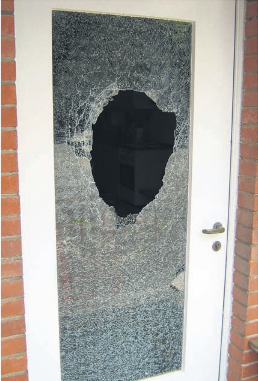
Die eingeschlagene Tür des Kindergartens am Langenlängeweg.
