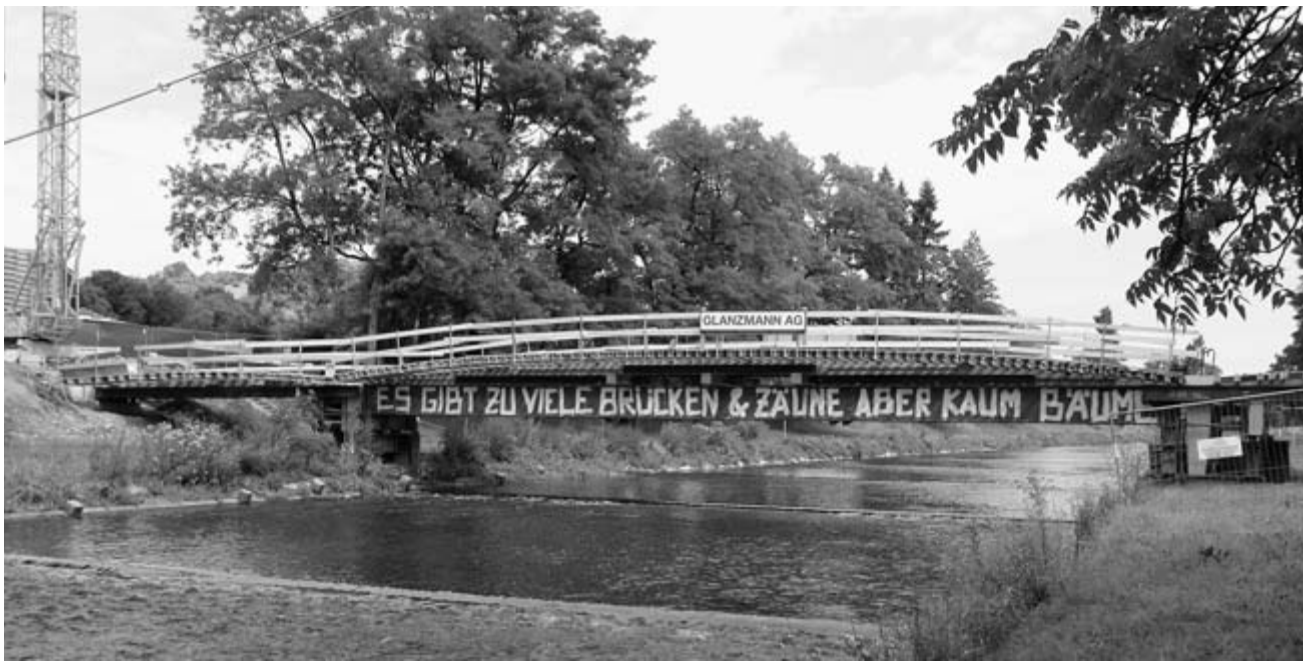
Der oder die Täter, die sich am vergangenen Wochenende an der neuen Brücke über die Wiese zu schaffen machten, gingen mit erheblicher krimineller Energie an ihr Zerstörungswerk.
