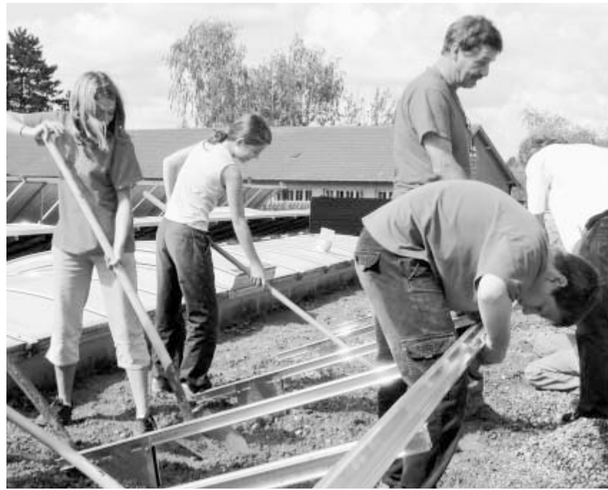
Schaufeln, bohren, schrauben: Schülerinnen und Schüler helfen, die letzten Module der Solaranlage auf dem Turnhallendach zu installieren. Foto: Sibylle Meyrat
