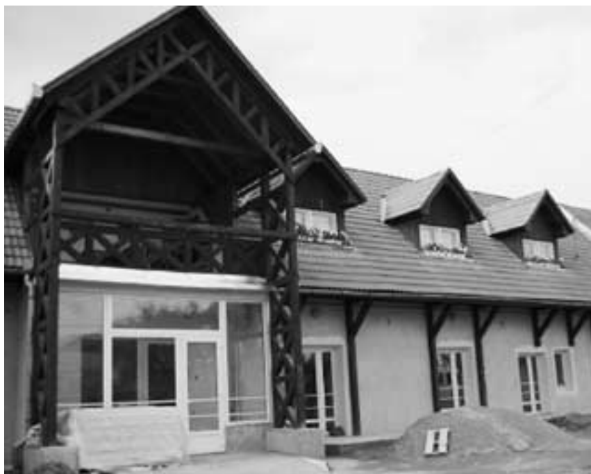
Das Vereinshaus des Vereins «Asociația Riehen» in Miercurea-Ciuc/Csíksereda kurz vor Vollendung des Einbaus eines Tagesheims für Betagte. Fotos: zVg
