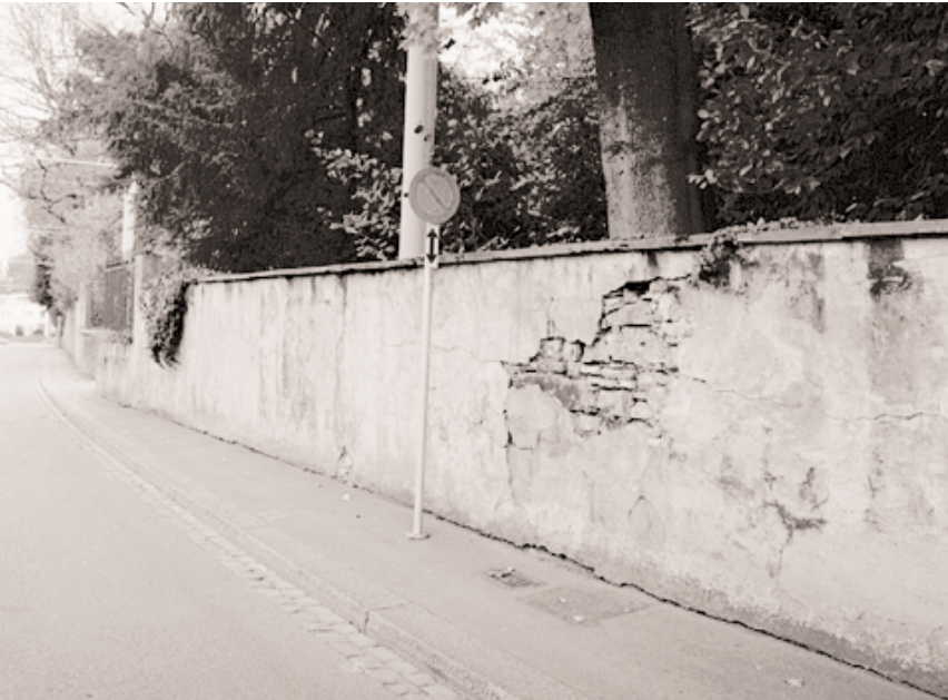
Die historische Umfassungsmauer des Sarasinparks weist grosse Schäden auf und soll nun demnächst saniert werden. Foto: RZ-Archiv
