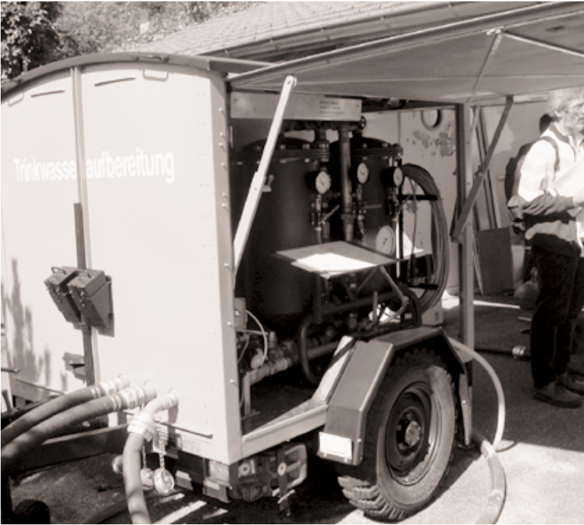
Die zehn Trinkwasseraufbereitungsanlagen sind in einachsigen Anhängern untergebracht und können so schnell und unkompliziert an den jeweiligen Einsatzort gebracht und in Betrieb genommen werden.
