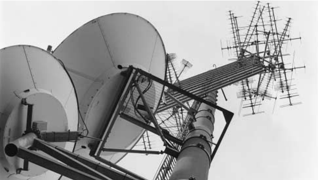
Wenn das Bettinger K-Netz voraussichtlich im kommenden Juli fertiggestellt sein wird, hat der Empfangsturm der Gemeinschaftsantennenanlage Im Britzigerberg (unser Bild) endgültig ausgedient.
