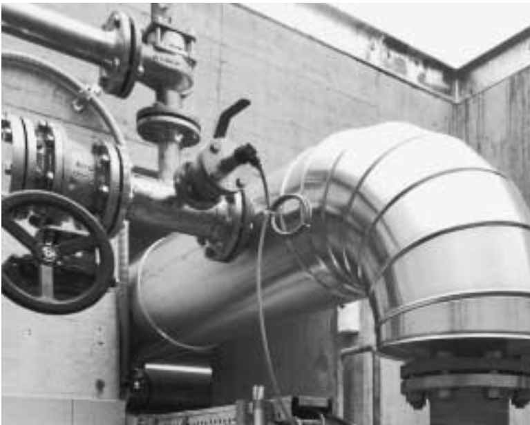
Die in der Geothermieranlage in Riehen (im Bild) geförderte Erdwärme soll über eine Verbindungsleitung nach Lörrach geliefert werden. Foto: RZ-Archiv
