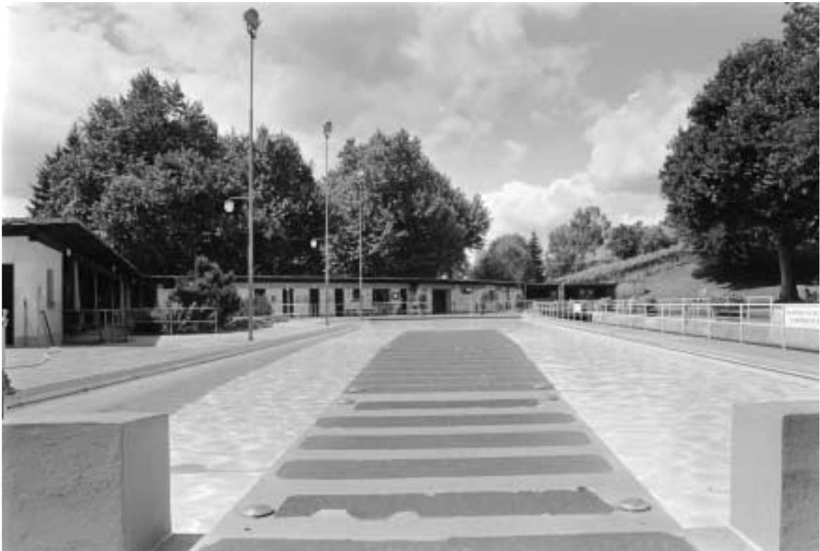
Vergangene Pracht: Zwar glitzert das Wasser vom Sprungbrett aus verführerisch, doch das Badevergnügen in der Riehener Badi scheint getrübt. Unter anderem ist das Bassin undicht und die Wasseraufbereitungsanlage veraltet. Foto: Amos Winteler
