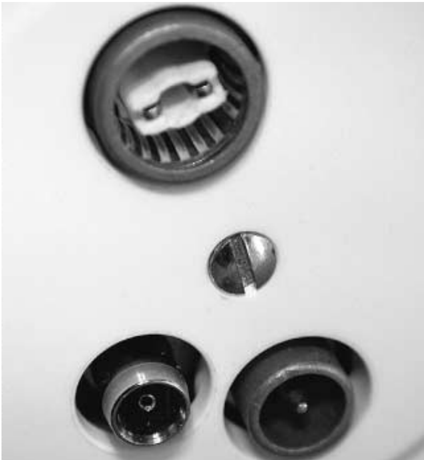
Multimediadose, mit der vom neuen K-Netz Fernseher, Radio und Internet angeschlossen werden können. Die Installation ist Sache der Hauseigentümer.
