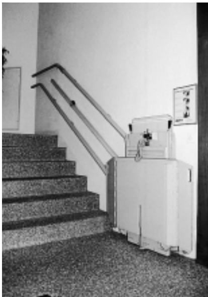
Treppenlifte wie hier im «Haus der Vereine» sind nur zu empfehlen, wenn andere Lösungen versagen.
