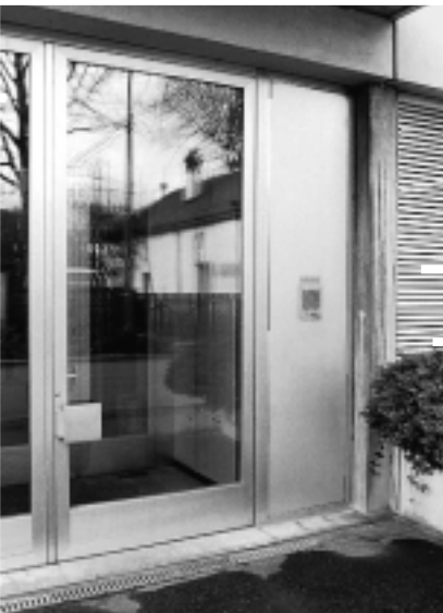
Der Eingang Bahnhofstrasse zum Riehener Gemeindehaus mit der zu hoch angebrachten Gegensprechanlage.
