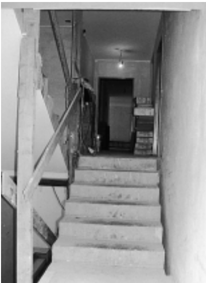
Diese sechs Stufen von der Eingangstüre zum Lift sind eine unnötige Barriere für Rollstuhlfahrer.
