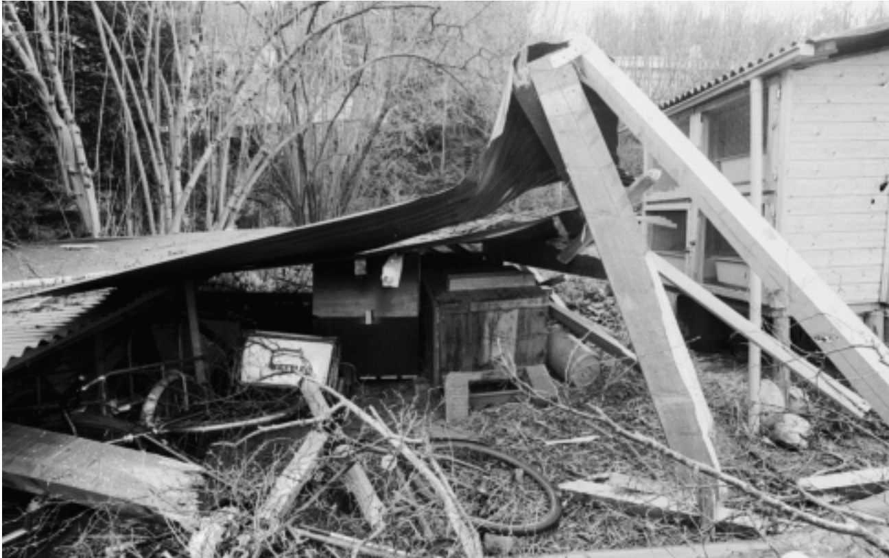
Umstürzende Bäume sorgten an vielen Orten für Folgeschäden. So wurde auch dieser massiv konstruierte Velounterstand im Baumgarten von einem geknickten Baum buchstäblich zertrümmert. Glücklicherweise blieb es in den beiden Landgemeinden bei allerdings beträchtlichen Sachschäden. Personen wurden nicht verletzt.
