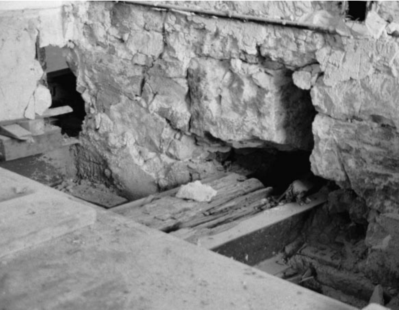
Erst bei der Freilegung wird das Ausmass der Schäden durch den Hausschwamm – hier im ersten Stock in der Berower-Villa – an Balken und Mauerwerk richtig deutlich.
