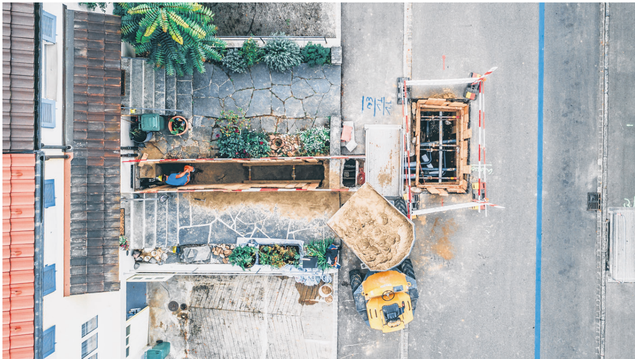
Der Wärmeverbund Riehen schliesst laufend neue Liegenschaften an.
