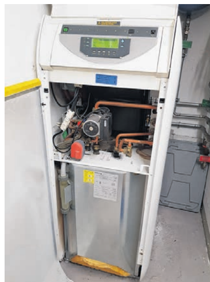
Gasheizung im Keller eines Einfamilienhauses.
