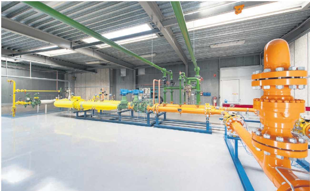
Erdgas Druckreduzierstation in Kleinhüningen.
