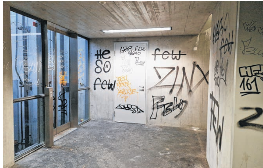
Sprayereien an den Wänden, den Türen und am Lift: Nicht nur aus diesem Grund bleibt die Passage zwischen Parkhaus und S-Bahn-Station vorerst geschlossen.
