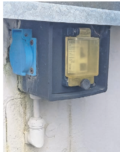
Foto eines Strom-Aussenanschlusses in Bettingen.
