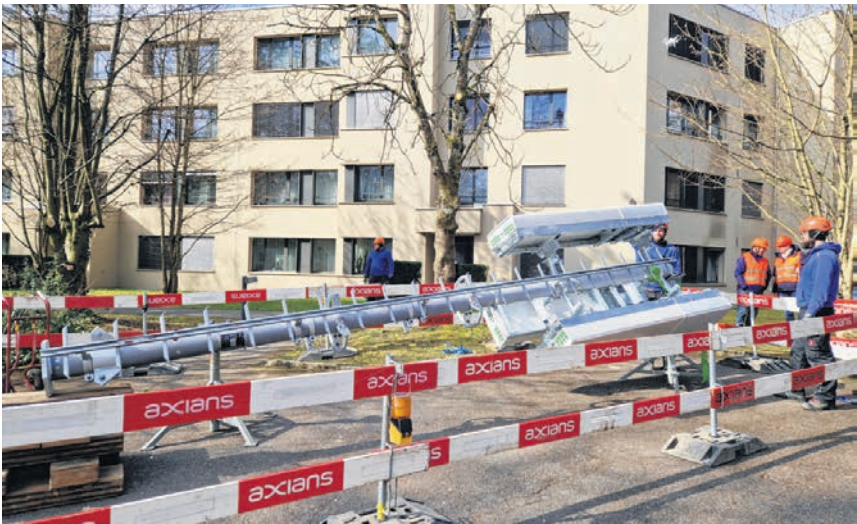
Sechs Meter lang, 800 Kilo schwer: Auf Augenhöhe liegend wird klar, wie gross solche Mobilfunkanlagen wirklich sind.
