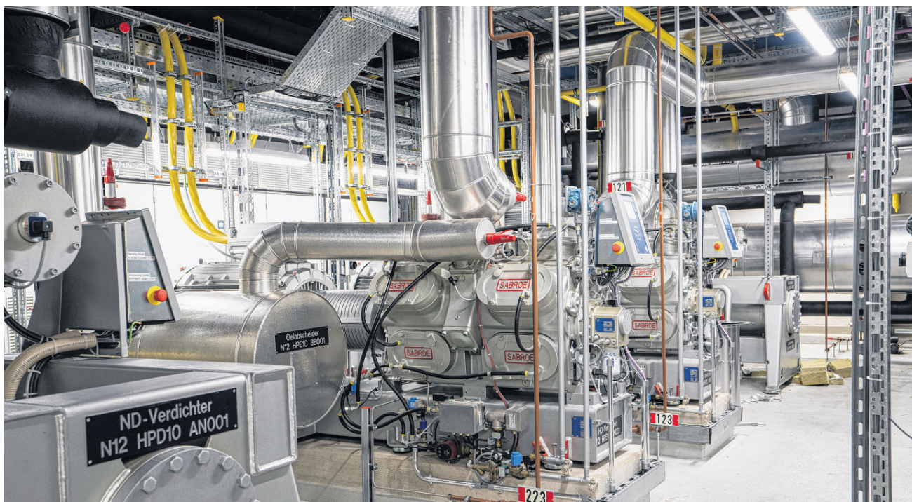
Wärmepumpen in der Zentrale der Wärmeverbund Lehenmatt Birs AG.
