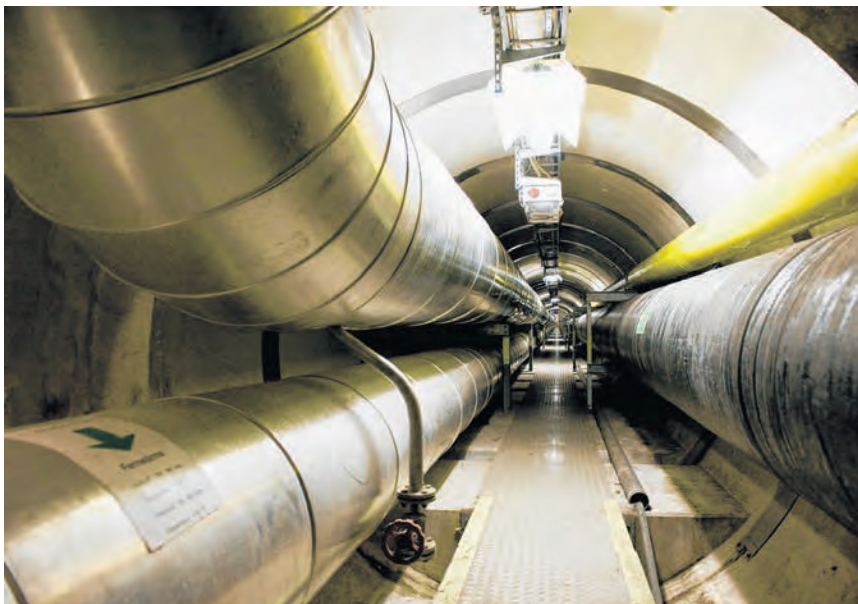
Die IWB wird künftig mindestens drei bis vier Jahre im Voraus die Stilllegung der Gasleitungen (gelb) ankündigen.
