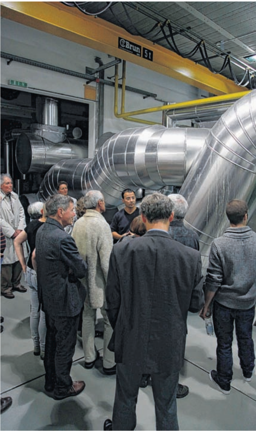
Herzstück der Grundlastzentrale im Haselrain 65 und des gesamten Wärmeverbundes ist die seit 1994 wärmeliefernde Geothermieranlage.
