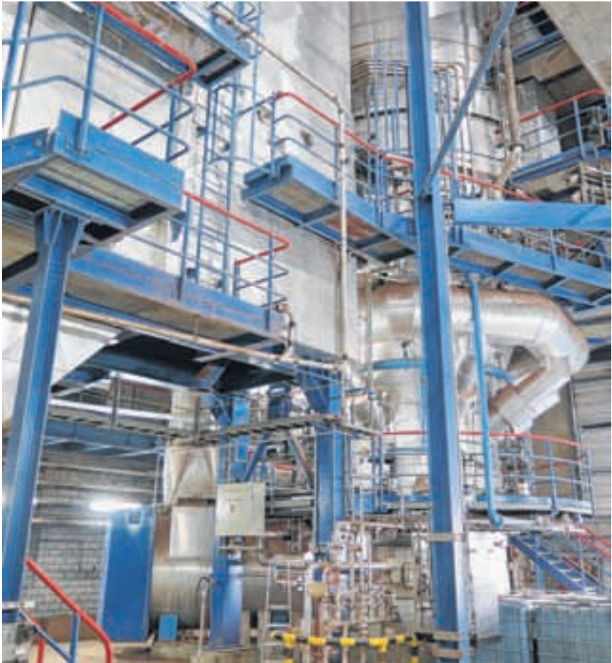
Diese Rohre gehören zum Gesamtsystem, das aus Verbrennungsabwärme Kälte für die Klimatisierung des Stücki-Einkaufszentrums macht. Foto: zVg Pro Reno
