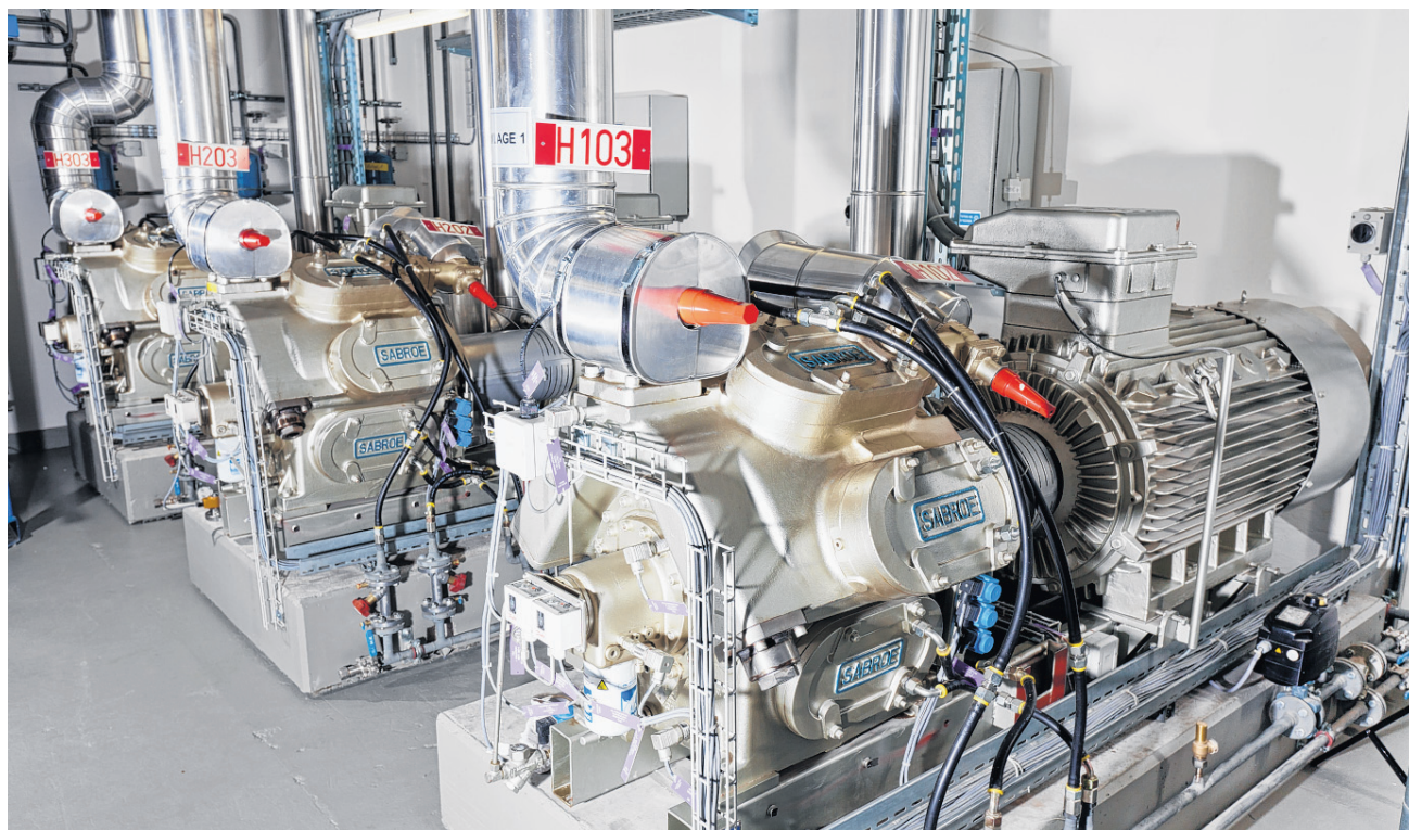
Verantwortlich für die Deckung der Grundlast: Drei Wärmepumpen nutzen Erdwärme zur Wärmeerzeugung. Foto: zVg
