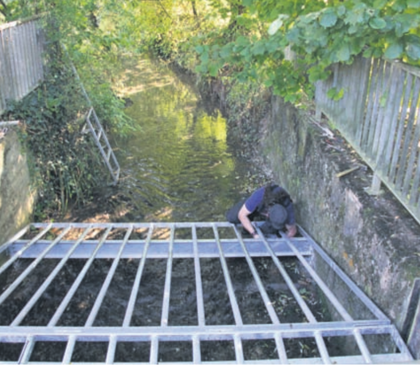
Der brandneue Einlaufrechen für den Aubach ist im Gegensatz zum Vorgänger mit einem flachen Winkel versehen. Damit soll das Treibgut leichter entfernt werden können. Foto: Michel Schultheiss
