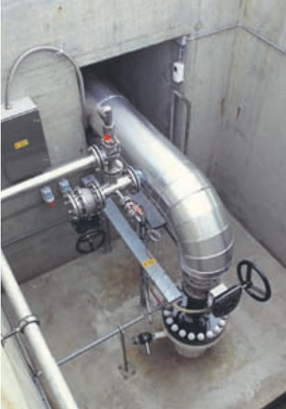
Brunnenkopf am Bachtelenweg, wo das Geothermiewasser gefördert wird.
